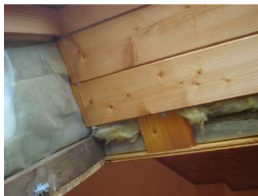
Netěsné napojení parotěsné vrstvy na střešní okno
